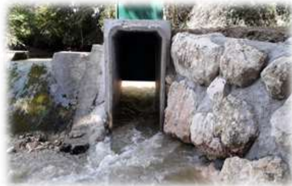
Figure 24 : Vanne de dégrèvement implantée sur le seuil de Nénigan
