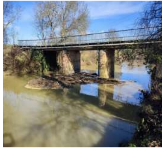
Figure 13 : Embâcle sur la Save à Espaon (Régie)
